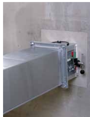
Zorgvuldig afgedichte brandwerende doorvoering
